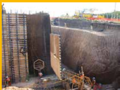
Pozo de toma de agua en UPM (ex-Botnia). Empresa Constructora: Cofigol Sac
